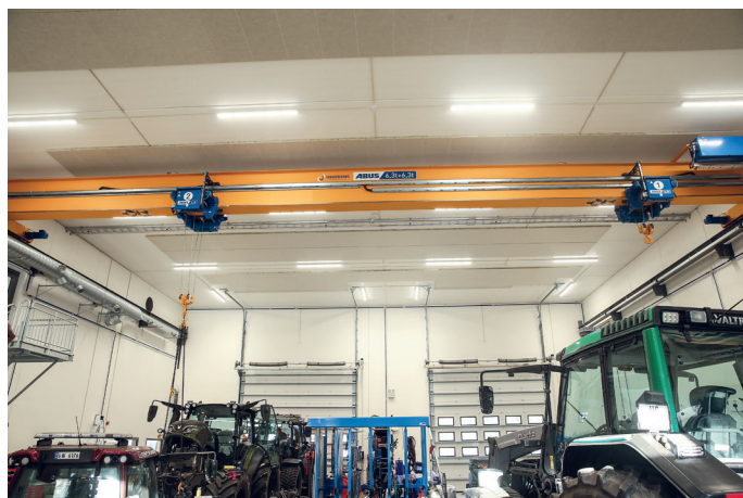
Traverskranen i taket i verkstedet kan løfte 6,3 + 6,3 tonn.
